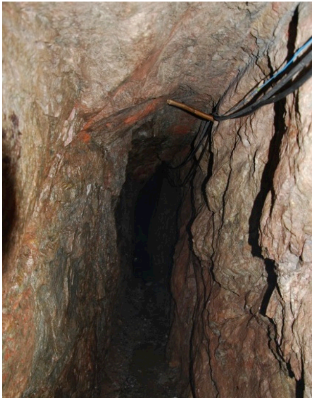
Câbles électriques et fils TPS sont maintenus au plafond
