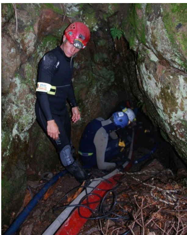
Les trois pompes sont en service, il faut les pousser au fur et à mesure que le niveau d'eau baisse.
