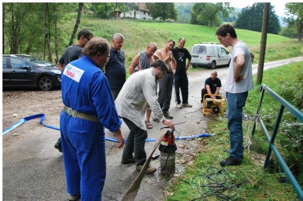
Les pompes sont testées avant de partir sous terre
