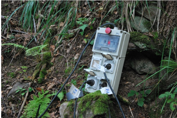
Les câbles, comme les tuyaux et les pompes, sont identifiés
